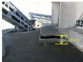
地盤沈下により生じた 排水機場建屋入口の段差
