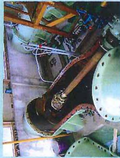
宇ノ気排水機場主ポンプの劣化(腐食、発錆)
