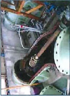
宇ノ気排水機場主ポンプの劣化(腐食、発錆)
