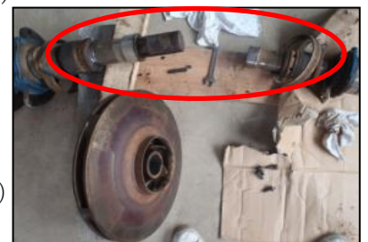
ポンプ主軸の破断による取水停止事故
