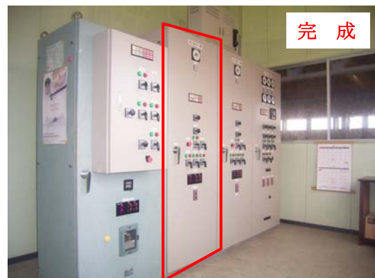
2号制御盤の更新
