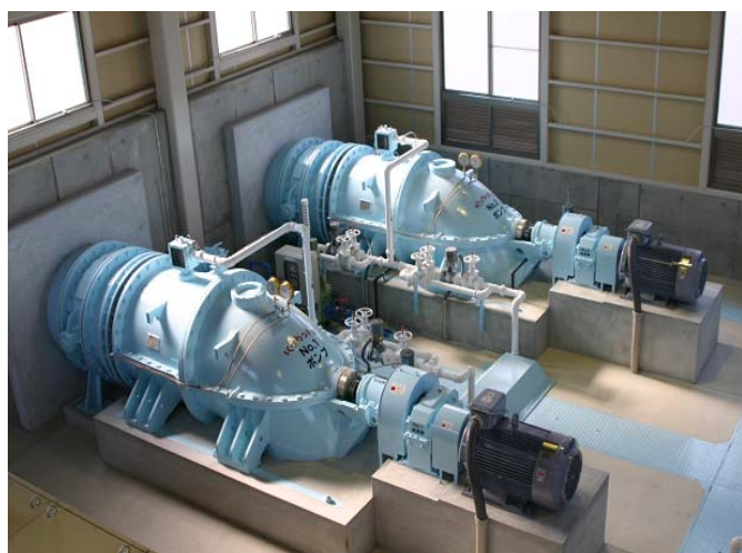
横軸軸流ポンプ φ1200mm×2台、排水量=5.85m 3 /s
